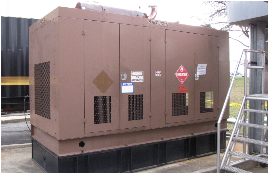
Bldg. 10 Emergency Gen.
